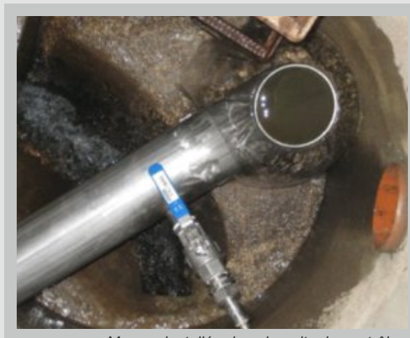
Mesure installée dans le puits de contrôle
