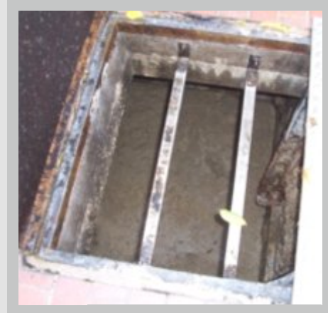
Puits récupérateur de graisses
