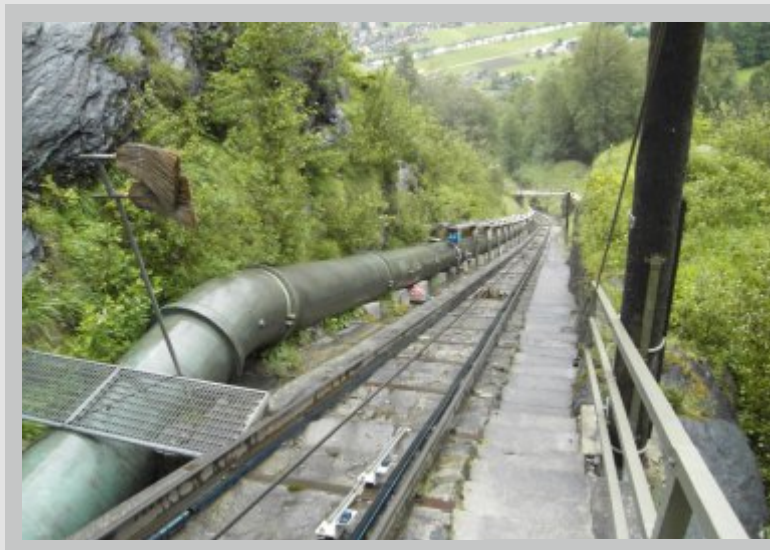
Conduite en pente en aval de la turbine
