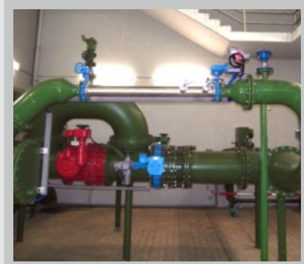
Point de mesure de l'approvisionnement nocturne dans la conduite bypass
