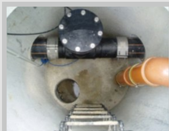
Point de mesure installé dans un regard standardisé
