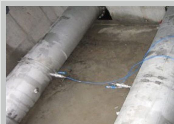
Puits de mesure en aval du désableur
