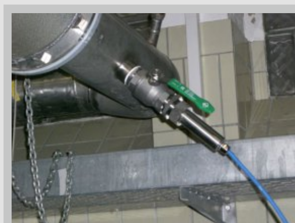
Point de mesure avec capteur installé
