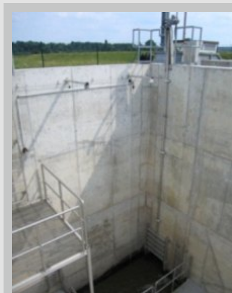
Zone d'entrée du mécanisme de relevage
