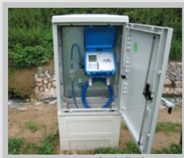
Armoire électrique ouverte avec convertisseur
