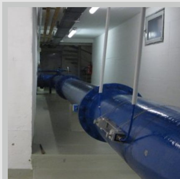
Mesure de débit par capteurs clamp-on
