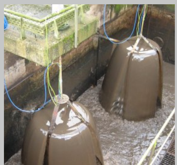
Conduite télescopique en exploitation
