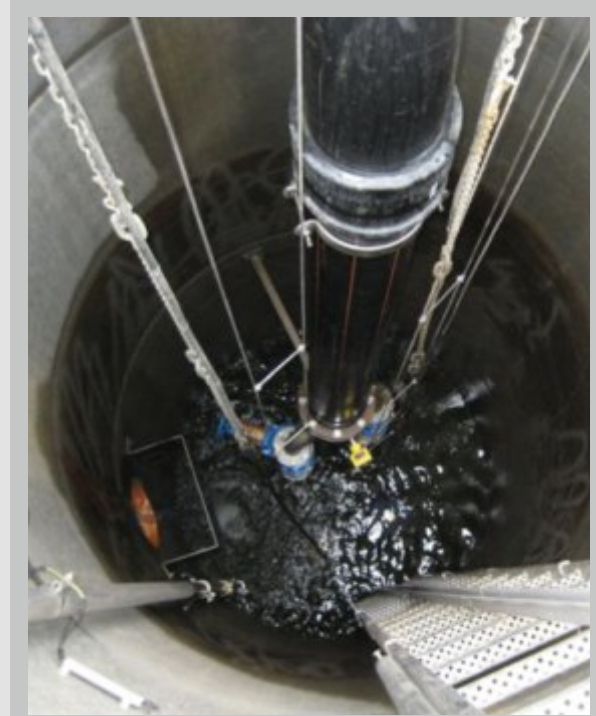
Puits de pompage avec deux pompes
