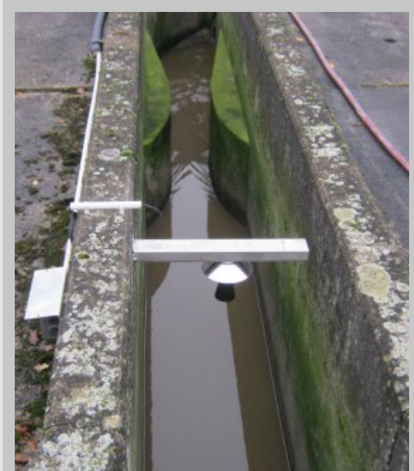
Mesure Venturi en sortie
