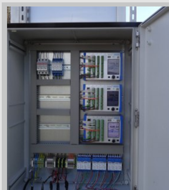
Transmetteurs installés dans l'armoire
