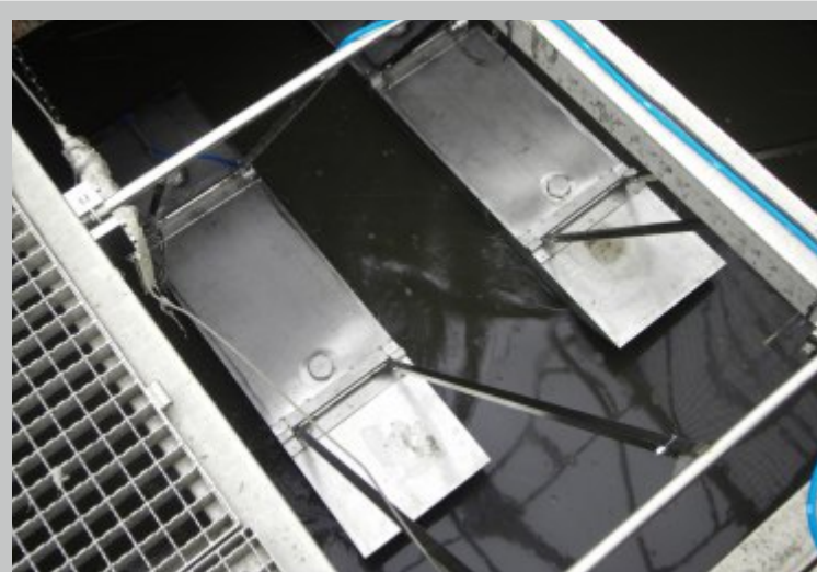
Ponton fixé par une barre de retenue
