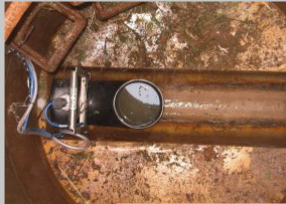
Système de mesure installé temporairement dans le canal
