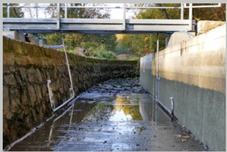
Point de mesure avec capteurs installés
