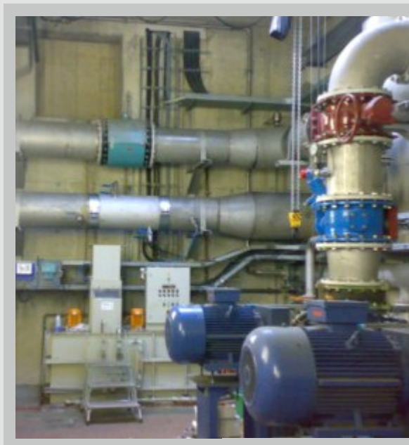
Salle de pompes avec conduite d'écoulement sur le mur du fond
