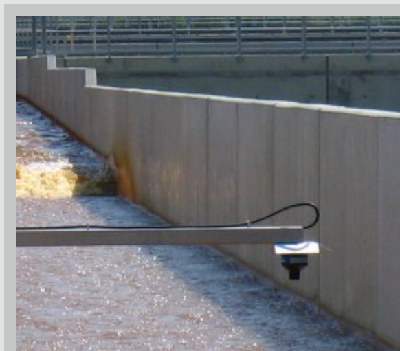
Point de mesure avec capteur de niveau
